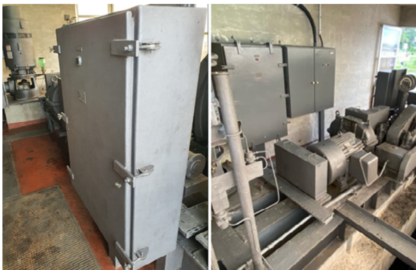
Figura 15: Fotos dos painéis das casas de máquinas.
