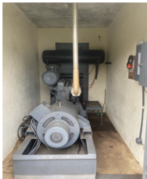
Figura 18: Conjunto do Gerador.
