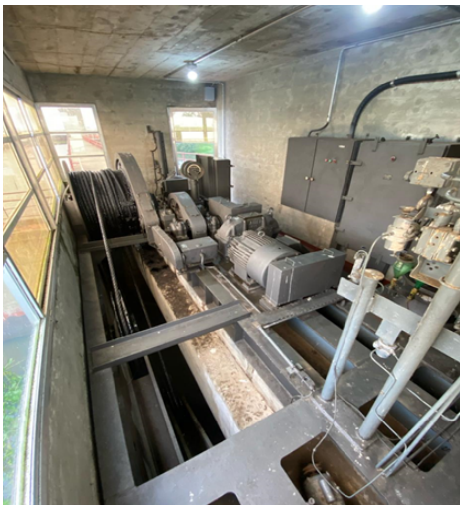
Figura 14: Foto do interior da casa de máquinas 1.
