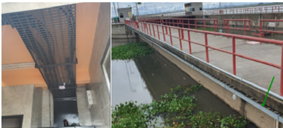
Figura 23: Eletrocalhas - Internas da Torre da Eclusa e Externas na Eclusa.
