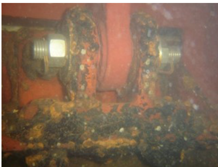
Figura 28: Foto detalhe da condição das partes submersas das comportas.
