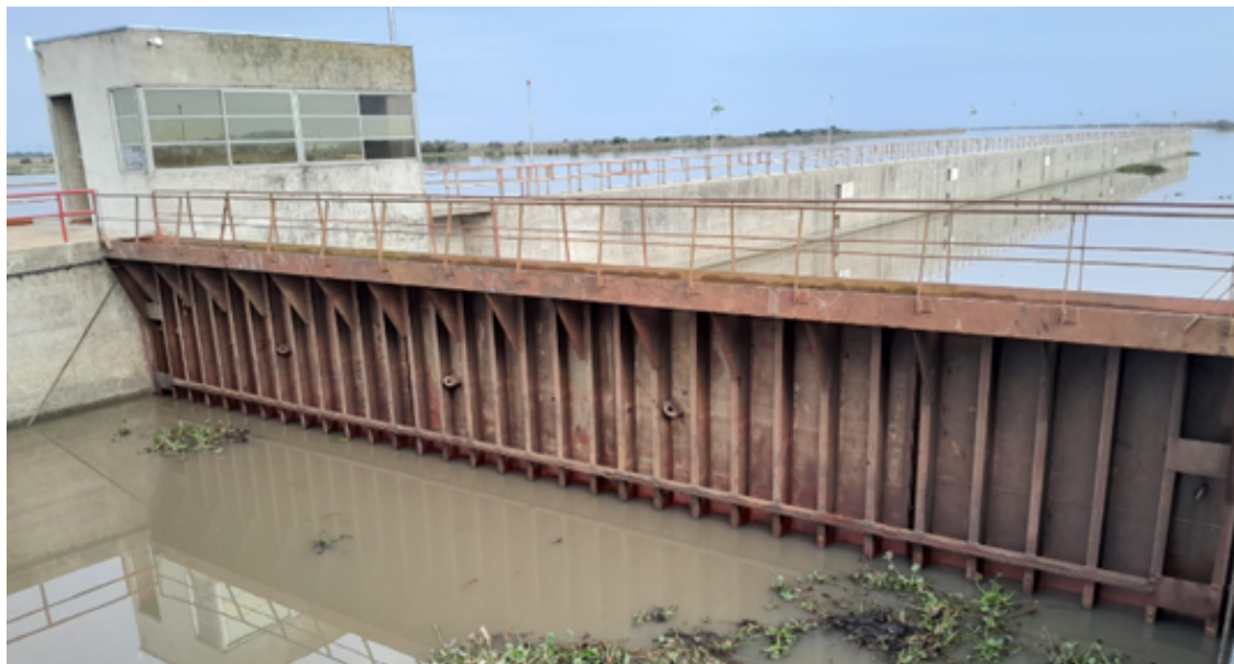
Figura 10: Foto detalhe da comporta de montante da eclusa.
