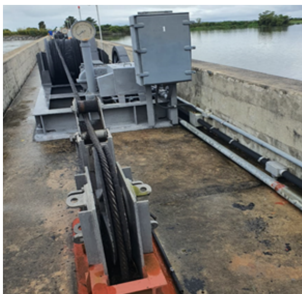
Figura 5: Sistema de guinchos das comportas.
