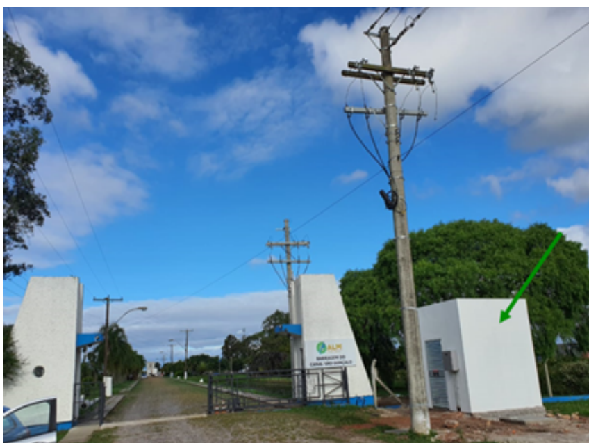
Figura 21: Cabine de Entrada.
